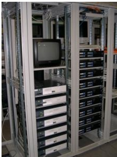
Une baie de serveurs
